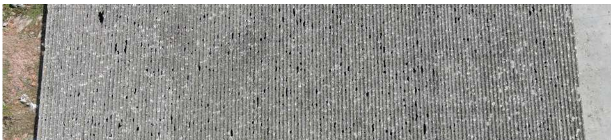
3. Danni al manto in fibrocemento
