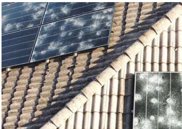
2. Danni all'impianto fotovoltaico
